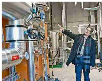
Walter Stauber führt durch die Heizzentrale der StWZ Energie AG beim Spital.
